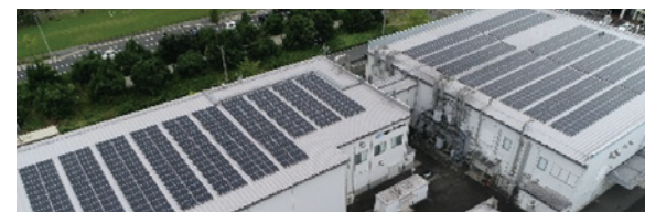
市原ファクトリーの太陽光発電パネル
