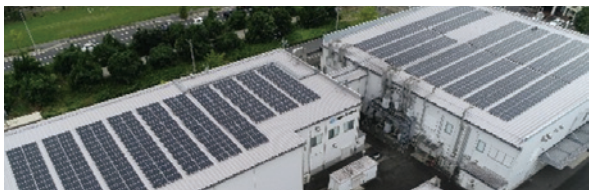
市原ファクトリーの太陽光発電パネル
